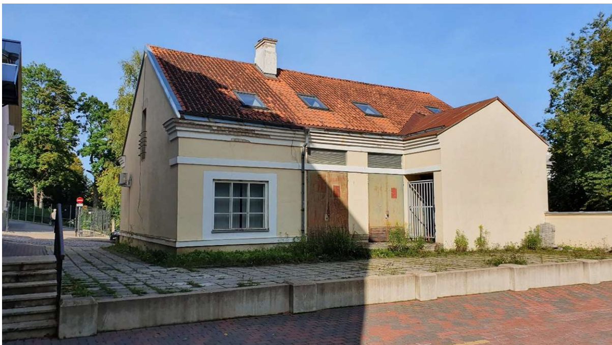
Pilt 21. Lossi tn 24 hoone, vasemal naaberkrunt Lossi tn 32, vaade edelast. Olemasoleval hoonel on näha mitmeid pragusid, mis viitavad konstruktsioonide vajumisele. Pilt Mart Hiob 2020.
