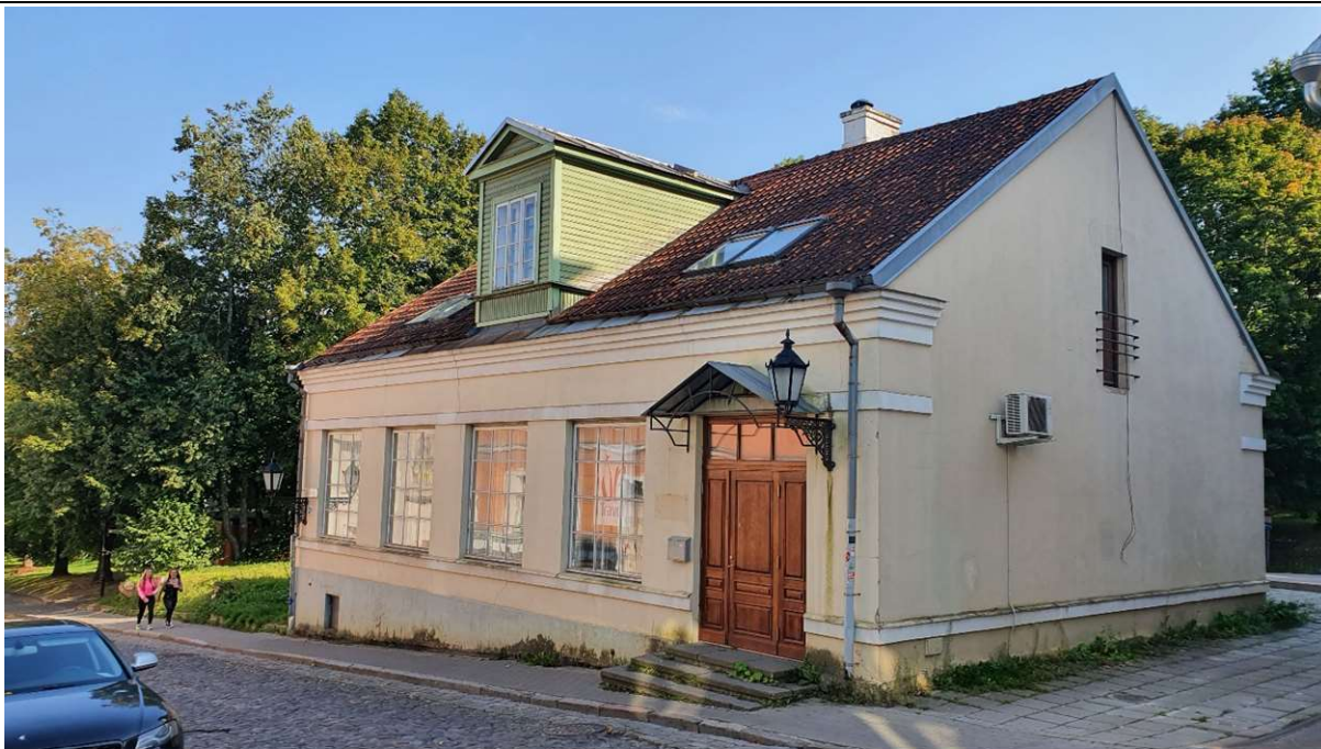
Pilt 15. Lossi tn 24 makettmaja, vaade loodest. Hoonel on fassaadil nähtav pragu, mis viitab vajumisele. Pilt Mart Hiob 2020.
